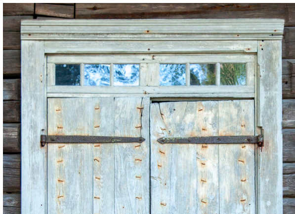
Kuva 17: Pellavaöljymaalin alle jääneet naulat ja teräskiinnikkeet ruostuvat, ellei niitä käsitellä ruosteenestolla ennen pellavaöljymaalausta.
