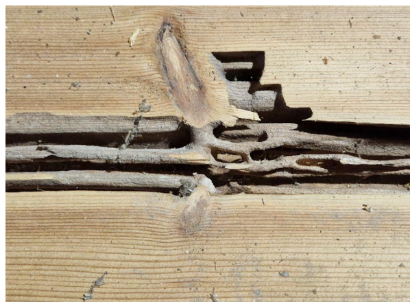
Kuva 12: Hevosmuurahaisten syömää ydinpuuta. (kuva: Perinnerakentaja Leo Lönnroth Oy)
