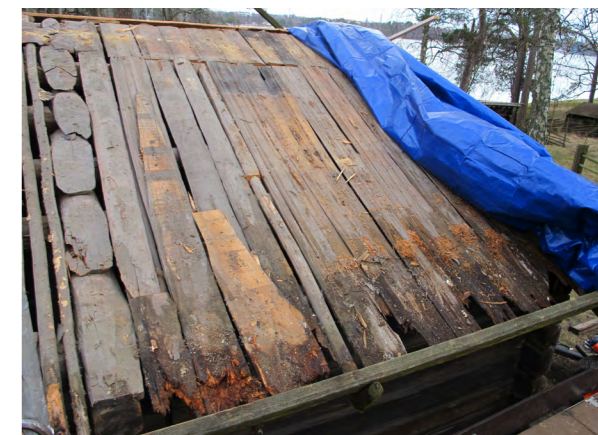
Kuva 11: Malkakaton vauriot dokumentoidaan ennen korjausta. Kuvassa näkyvät lahovauriot erityisesti räystäällä. Juurikoukku kuvan keskellä on jo kertaalleen uusittu ja kiinnitetty lappeen puoliväliin.
