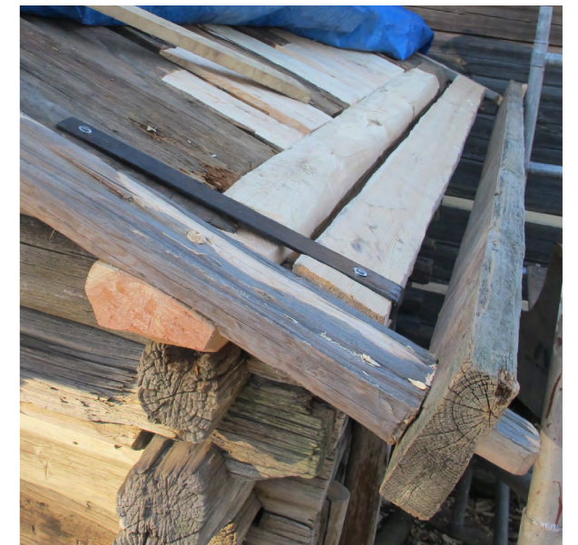
Kuva 26: Miekkapuu ja siderauta. Miekkapuu kantaa räystäslankkua. Siderauta taas varmistaa räystäspalkin paikoillaan pysymisen ja vähentää seinähirren päähän tulevaa rasitusta. Sideraudan käyttö on hyväksyttävää, jos sen avulla pystytään säilyttämään alkuperäisiä rakenneseosia. Huomaa, että tässä erikoistapauksessa aluskate nojaa ylimpään hirteen.
