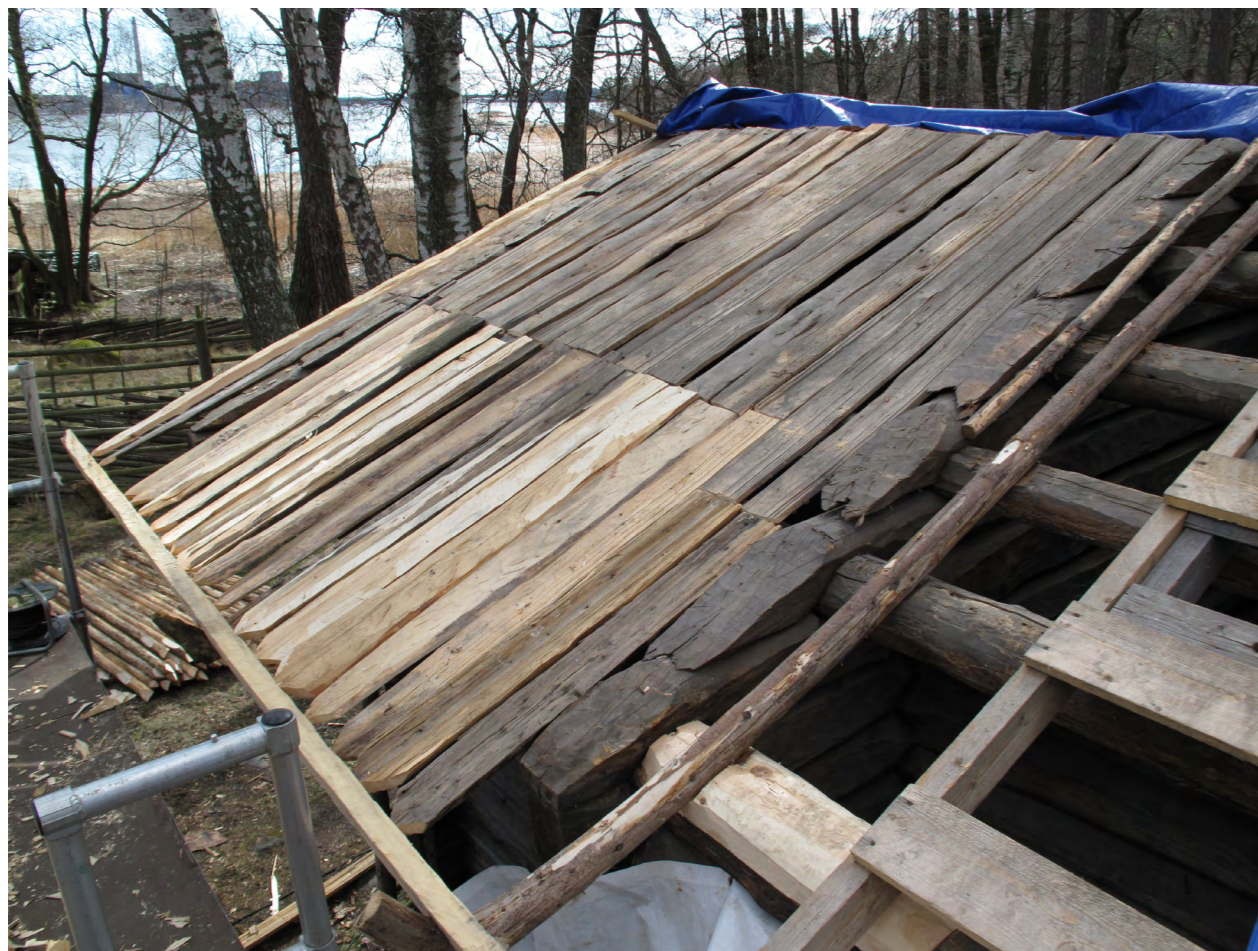
Kuva 10: Tämän malkakaton korjauksessa aluslaudoitus on korjattu lappeen puolivälistä lähtien käytännössä kokonaan. Etualalla myös uusittu juurikoukku.
