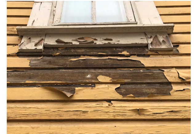
Kuva 12: Liian tiivis maalipinta lahottaa ulkolaudoituksen maalipinnan alta.
