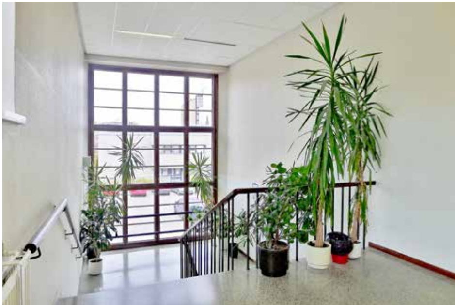
Koulun pääportaassa on 1930-luvun arkkitehtuurille ominainen lähes koko seinäpinnan kokoinen ikkuna. Kuva ark-byroo 2016.
