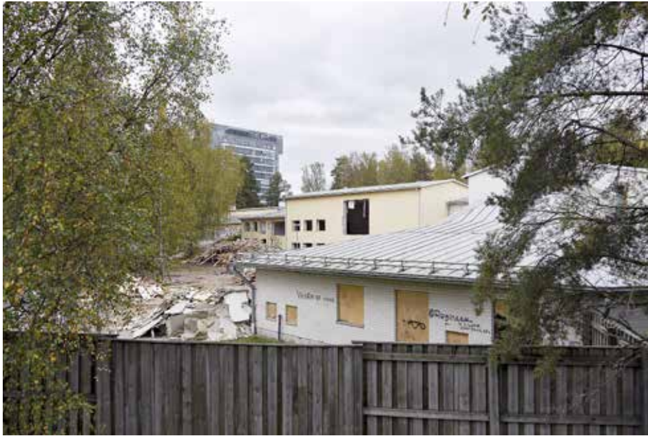
Mårtensbro skola vuodelta 1956 purettiin vuonna 2016. Sen viereen rakennetaan Espoonlahden uutta metroasemaa. Kuva ark-byroo 2016.
