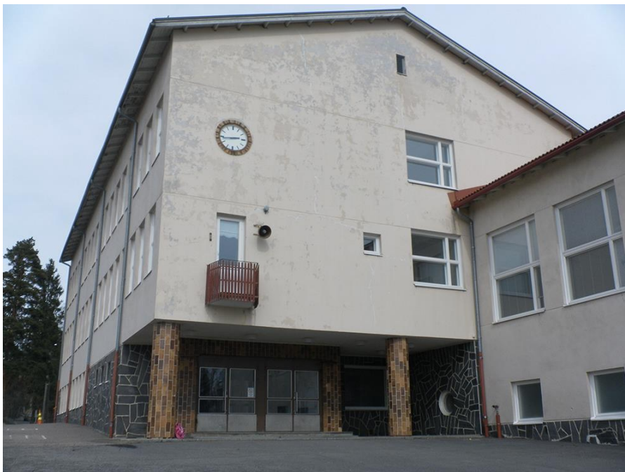
Nahkialan koulu, 1951. Siporexin eli kevytbetoniharkkojen päälle rapatussa julkisivussa erottuu normaalia enemmän halkeamia. Kuva: Rakennusinsinööri-toimisto Jommi Suonketo.
