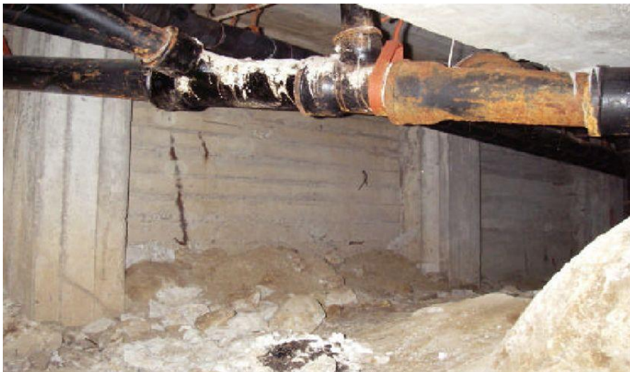
Toijan yhteiskoulu, 1968, puhdistettu ryömintätila. Kuvan onkalotilasta oli kaksi vuotta aiemmin poistettu lahoja muottilautoja ja tilan kuivausta oli parannettu. Lopputulos oli hyvin siisti lähtötilanteeseen nähden. Viemärien ikääntyminen kasvaminen aiheutti vuotoriskiä ja sen toteutuessa uusia ongelmia. Kuva: TTY, Elinkaariteknikan tutkimusryhmä, kuntotutkimukset.
