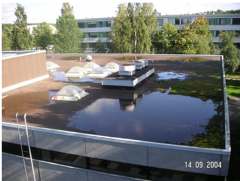
Hepokullan koulu, 1977, vesikatto. Betonirakenteiden ajan saatossa tapahtuvan taipuman lisäyksen eli viruman merkitystä ei vielä 1970-luvulla osattu huomioida. Kuvassa kattokaivot ovat rakennuksen keskilinjalla tuen kohdalla, ja viruman takia luokkatilojen katolle syntyy suuria lammikoita. Veden jäätyminen rikkoo toistuvasti katetta. Kuva: TTY, Elinkaaritekniikan tutkimusryhmä, kuntotutkimukset.
