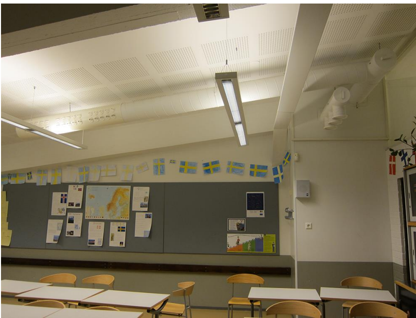
Rei'itetyt sisäänpuhalluskanavat ovat yleisimpiä ratkaisuja luokkien tuloilman puhallukseen. Näin myös Herttoniemen yhteiskoulussa. Kuva: Jukka Sainio.
