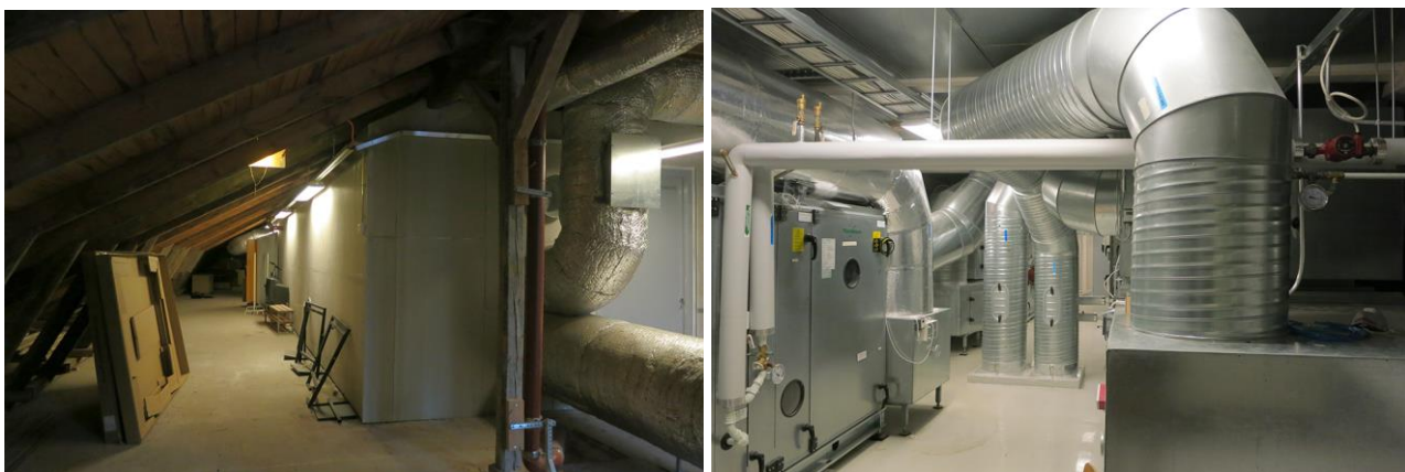
Vasemmalla Rekolan koulun konehuone ullakkotiloissa. Oikealla ilmanvaihtokonehuoneen kanavia ja kojeita. Liikaa tilaa ei konehuoneisiin yleensä jää. Kuvat: Jukka Sainio.
