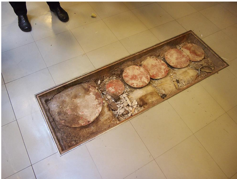
Roihuvuoren alakoulussa oli alun alkaen koneellinen ilmanvaihto. Alkuperäiset ilmanvaihtokanavat sijaitsivat ala- ja yläpohjissa. Uudet kanavat sijoitettiin alkuperäisillä periaatteilla, kokonaan eri mittakaavassa. Kuva: Mikko Lindqvist, Helsingin kaupunginmuseo.
