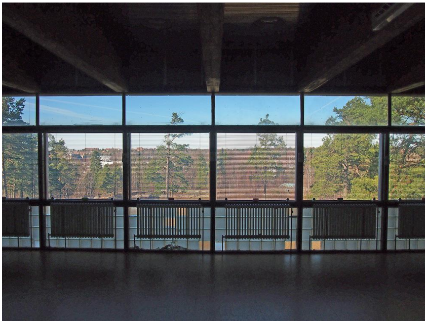
Roihuvuoren alakoulun valoisa luokat avautuvat yhtenäisin lasirakentein ympäröivään metsäpuistoon. Rikkoutuneet lasitiilet oli korvattu erilaisilla lasitiilillä. Välitilaan jäänyttä lasimursketta ei voitu poistaa, sillä huoltomahdollisuus puuttui. Kuva: Mikko Lindqvist, Helsingin kaupungin museo.
