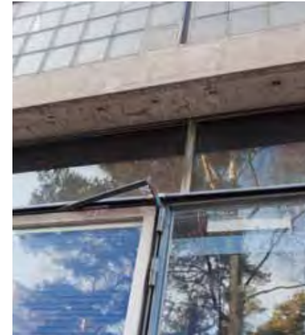
Keittiön oven yhteyteen myöhemmin asennettu aukeamista rajoittava uloke.
