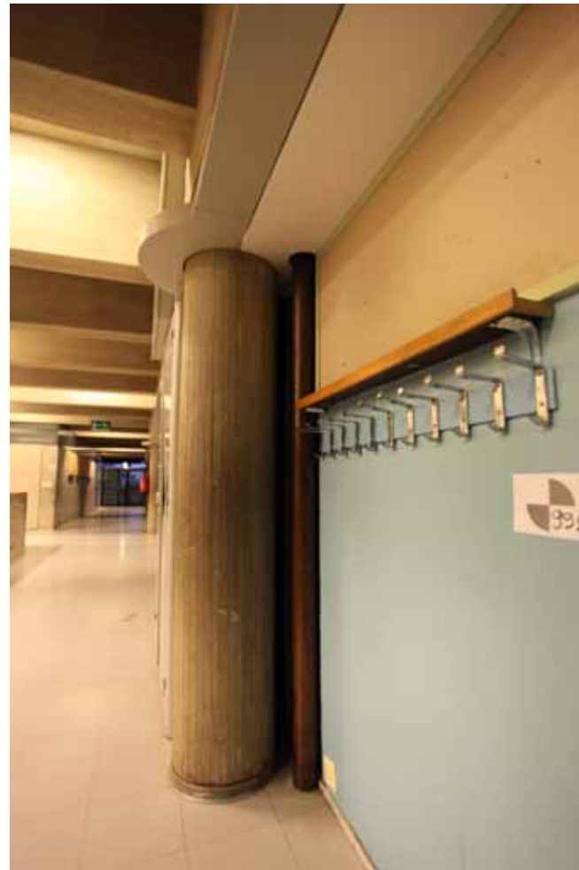
Kupariset sadevesiputket näkyvät käytävillä (212).
