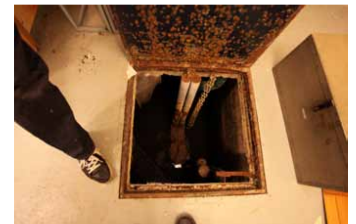
Perusvesikaivo on kellarissa. (003).
