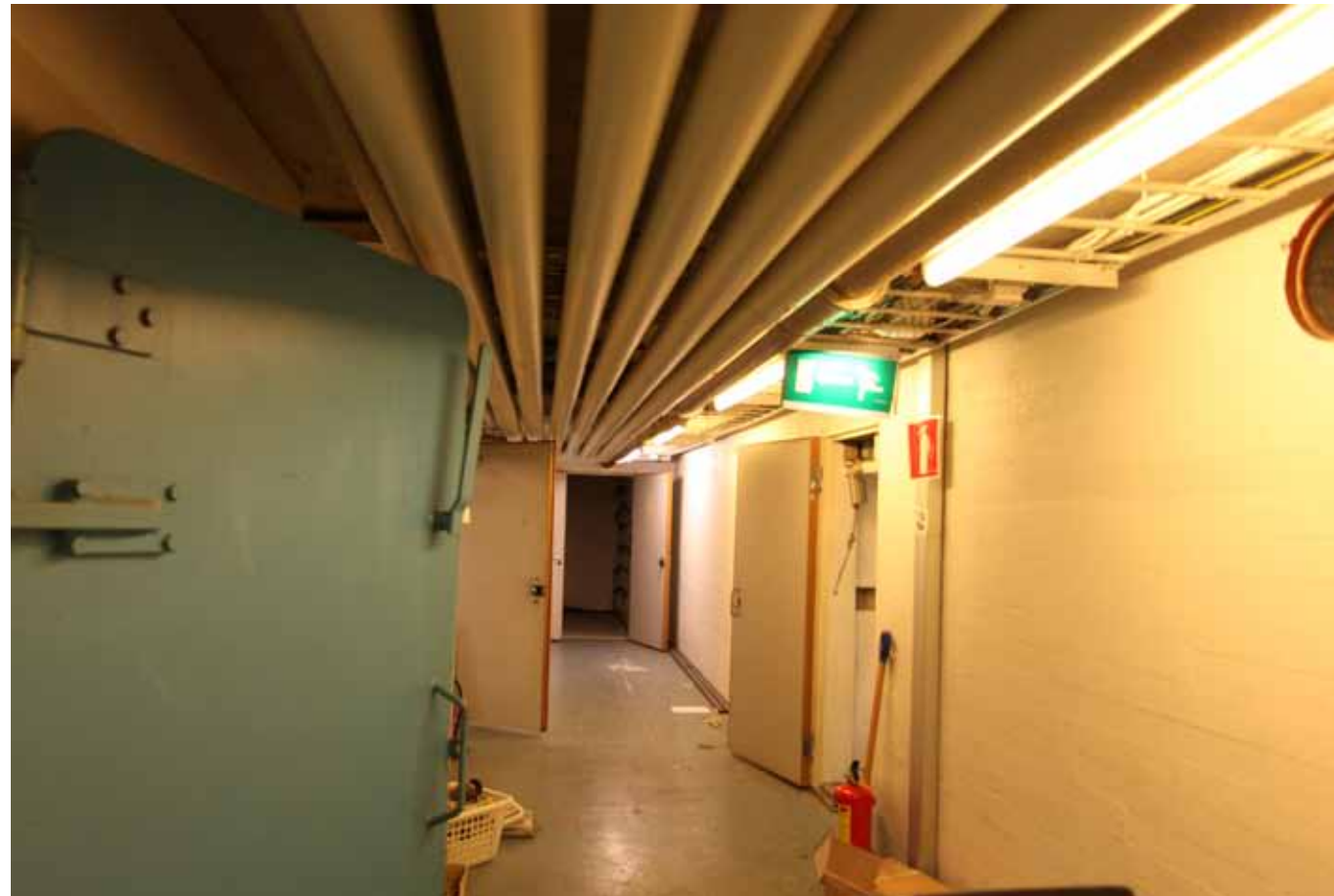
Putkia kellarin käytävän (001) katossa.
