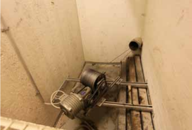
Ensimmäisen kerroksen paljeovea liikuttava moottori on omassa tilassaan.
