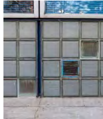
Lasitiiliä on itäjulkisivulla rikkoutunut vähemmän kuin länsisivulla. Teknisten käsitöiden tilan ilmanvaihtorilät ovat hyvin todennäköisesti lasitiilikenttien alkuperäisiä rakennusosia.
