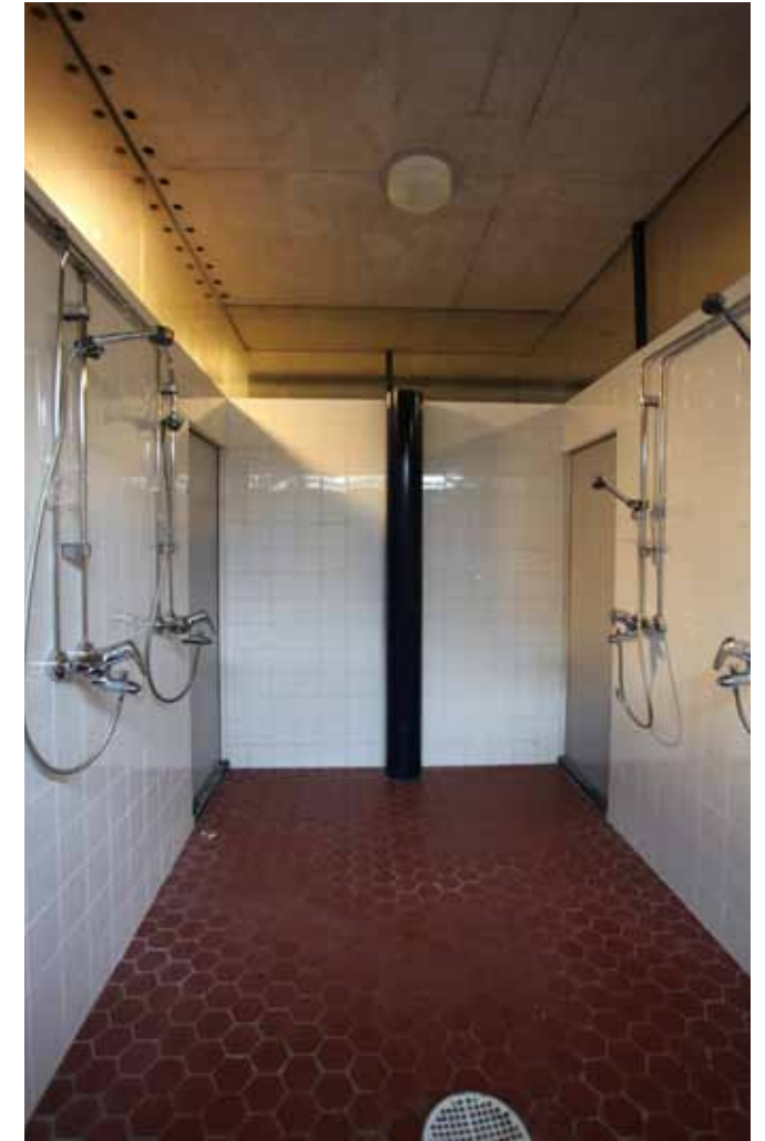
Mustaksi maalattu tuloilmaputki suihkuhuoneessa (152). Ylälasin vieressä olevat siirtoilma-aukot osoittautuivat riittämättömiksi.
