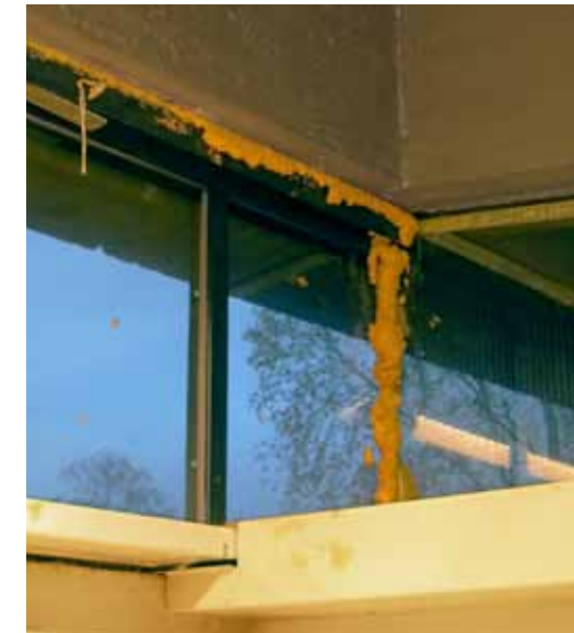
Väliaikaista lisäeristystä pohjoissivun yläosan nauhaikkunassa sisältä nähtynä. Karmin ja betonirakenteen liittyminen, joka suunniteltiin sallimaan betonirakenteen muodonmuutokset, ei ole enää toiminut. Myös puskusaumoilla toisiina liitettyjen lasien saumaan on lisätty eristettä.
