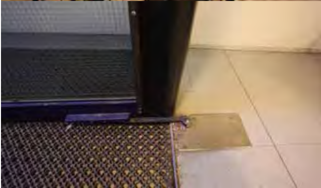
Tuulikaapissa 124 on säilyntä alkuperäinen lattiaan asennettu ovi- pumppu.
