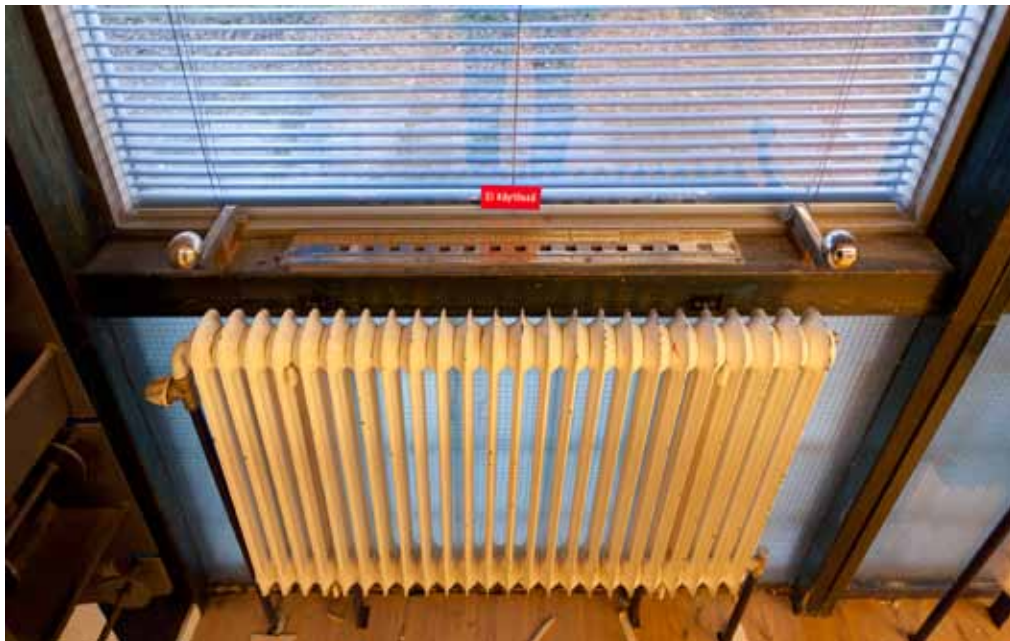
Teknisen käsityön opetustiloissa on muutaman ikkunan yhteyteen jo alun perin tehty ylimääräiset korvausilman tuloaukot. Julksivussa tämä näkyy siten että lasitiilikentässä yksi tiili on korvattu metallisritilällä.
