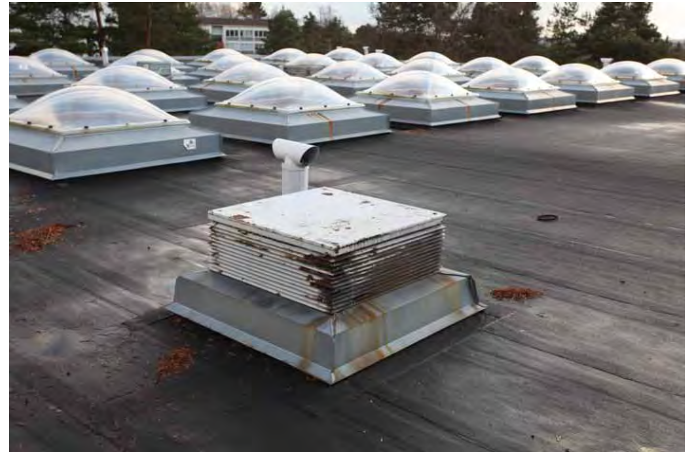
Lännen puoleisten luokkahuoneiden poistoilmaelementti katolla.
