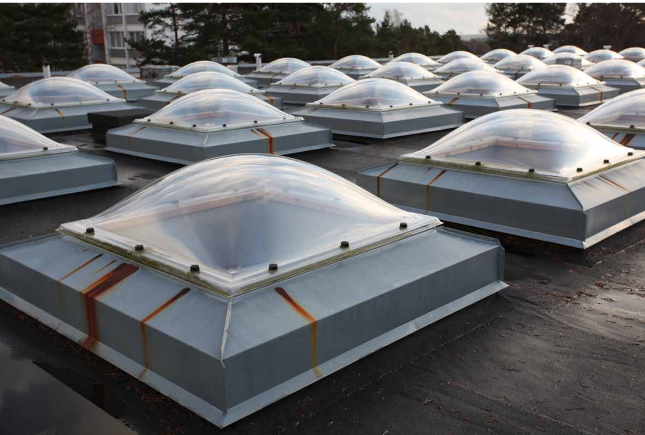
Muoviset kattoikkunat hallitsevat kattomaisemaa. Ne on uusittu 1990-luvulla. Samalla niitä on nostettu korkeammalle. Alun perinkään niitä ei asennettu niin matalalle kuin Rakennuslaskelmissa esitetään.
