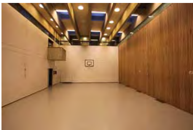
Nuorisokerhon juhlasalin (132) tuloilmaritilät ovat lattiassa puuseinän vieressä.
