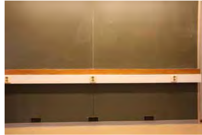
Ensimmäisen kerroksen pienet poistoilmaritilät on sijoitettu seinien alaosiin. Tekstiilityöluokassa (122) niitä on liitutaulun alaosassa.
