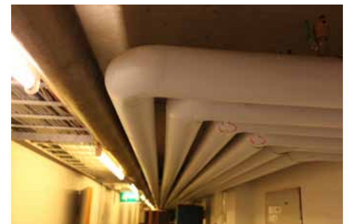
Lämpöputkia kellarin käytävän (001) katossa.
