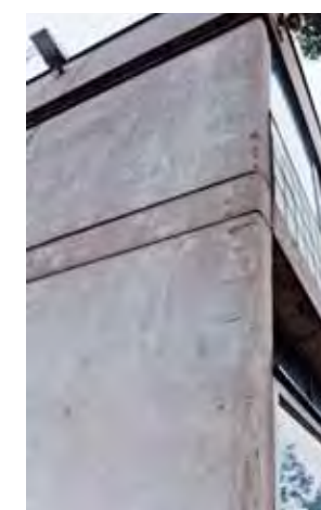
Raudoitusten paljastumista betonielementeissä rakennuksen luoteisnurkassa
