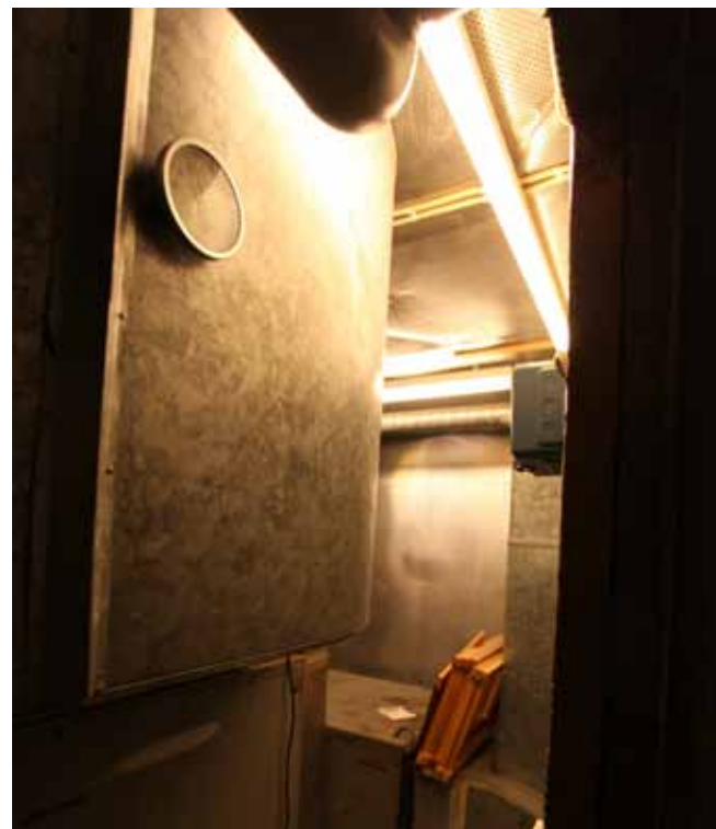
Ilmanvaihtokonehuone (013) on ahdas.
