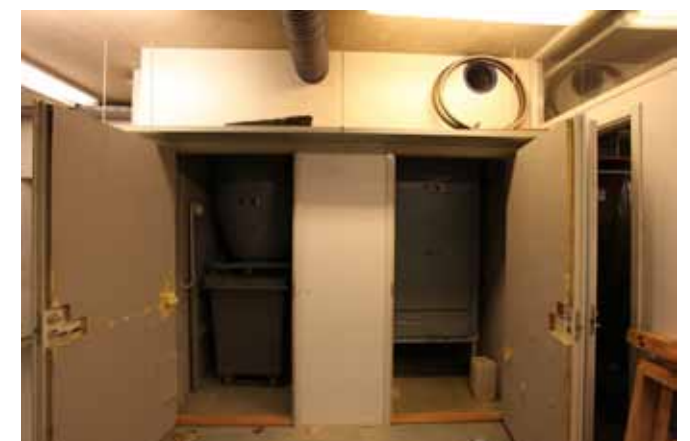
Teknisen työn opetustilojen purunpoistolaitteisto on tilassa 169.
