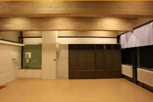
Teknisen työn tiloista tuleva poistoilmaputki on kotoitettu lastulevylä. Tila 224.
