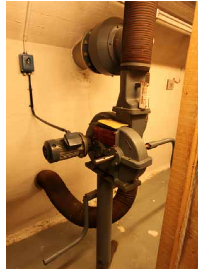
Väestönsuojassa (009) on käsikäyttöinen ilmanvaihtolaitte.
