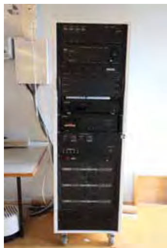
AV-laitteet vahtimestarin huoneessa (170).
