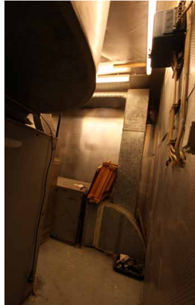
Ilmanvaihtokonehuone (013) on kellarissa.
