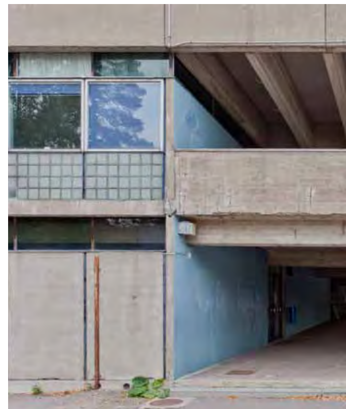
Julkisivun ja katoksen parvekkeen liittyminen. Sinisessä seinässä katoksen alla toisessa kerroksessa ollut kello on poistettu. Ensimmäisessä kerroksessa on asennettu (sittemmin hajonnut) valaisin alkuperäistä ylemmäs. Kaiteesta sojottaa myöhemmin lisätty vedenpoistoputki. Betoniseiniin on on tehty sähköjohtojen pinta-asennuksia.
