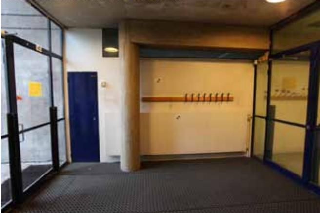
Tuulikaapeissa ja varaportas-tiloissa on sähkökomeroiden umpinaiset teräsovet. Ryhmätaulut eivät ole enää käytössä, mutta ovet ovat säilyneet.
