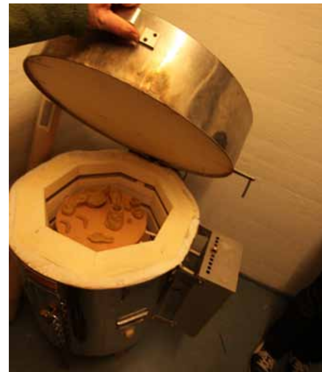
Väestönsuojan sulkuhuoneessa (008) on keramiikkauuni.
