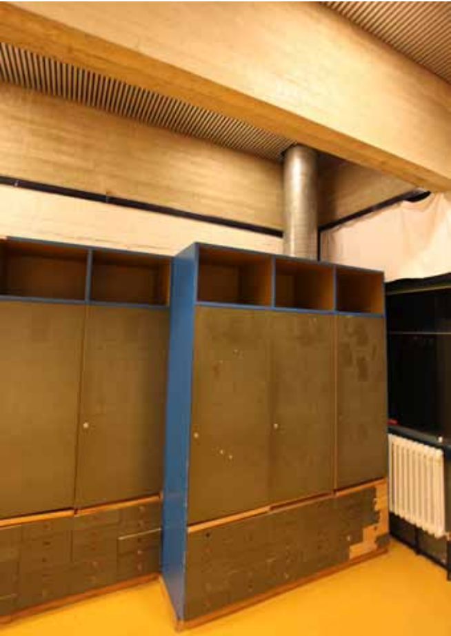
Jälkiasennuksena tehty keittiön poistoilmaputki on piilotettu kalusteen taakse. Tila 223.
