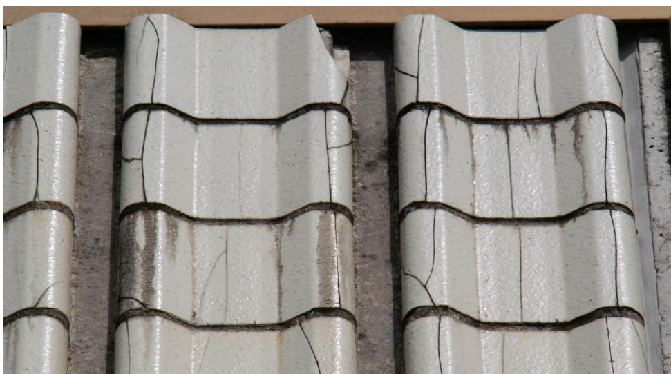
Studio Elsan julkisivuelementtien laatat olivat halkeilleet. Laattojen taustaprofiili ei ollut kestänyt betonin lämpöelämistä yhtä hyvin kuin alkuperäisten laattojen taustaprofiili. Elsan julkisivuelementit uusittiin lähes kaikki. Kuva: LPR-arkkitehdit Oy 2015.
