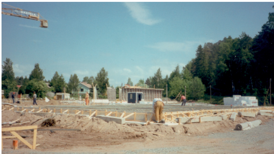
Turun Pansion terveysaseman perustusten valua. Kuva Helinä Kotilainen.
